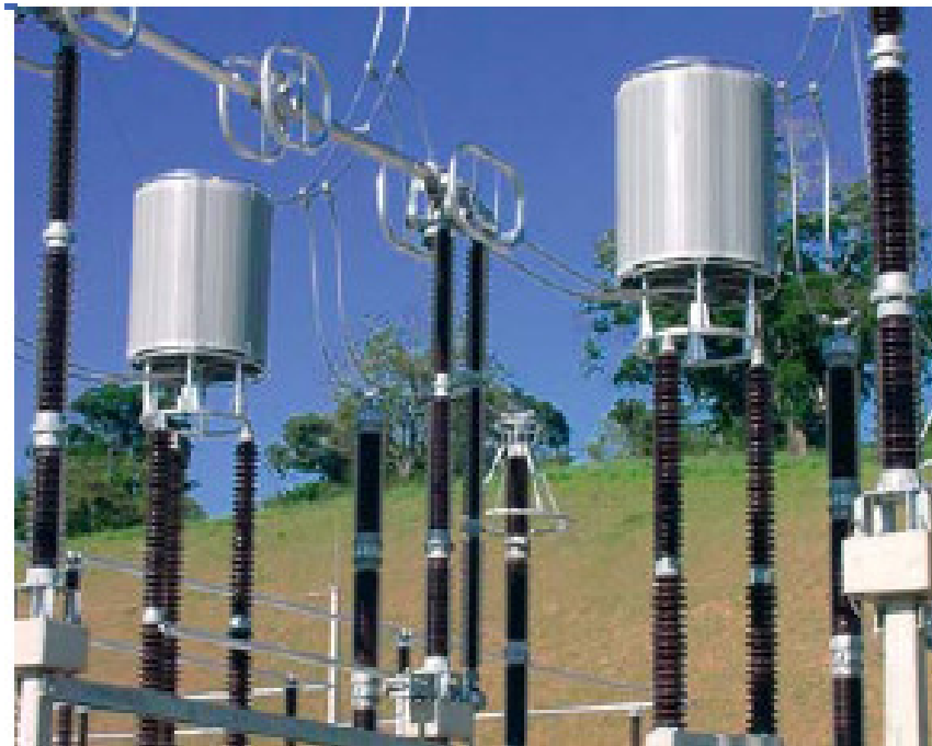
Figura 2.6: Bobina de bloqueio e Capacitor de acoplamento.
